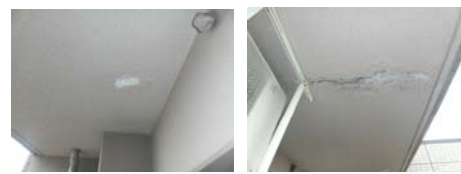
最上階ベランダ底部分より漏水
