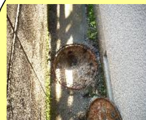
【柵が朽ち周囲の土が崩落】
