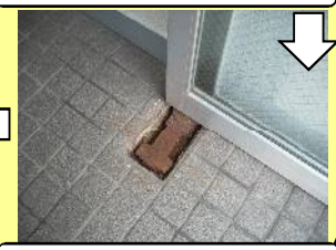
ヒンジが錆で腐りかけている
