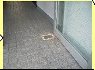
蓋の劣化部を長年テープで固定
