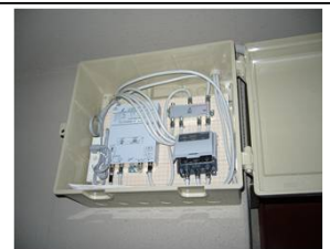
分配器・ブースター新設
